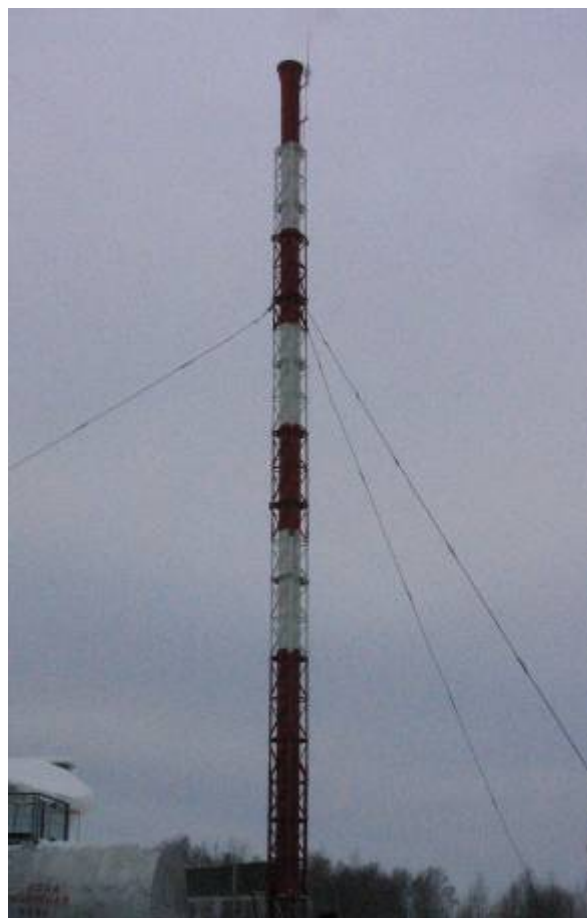
Рис. 2. Дымовая труба H=30 м D=0,6 м с газоотводящим стволом из ПКМ ЦДНГ-9 «Шумы» (ООО Лукойл-Пермь)
